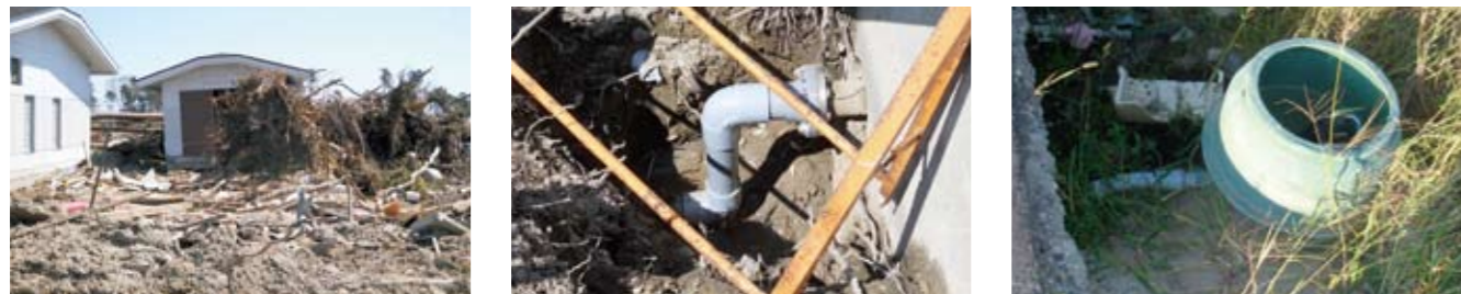
写真2. 津波被災地区 (左:処理場の津波被害、中央:処理場につながるPE管、被災なし、右:真空弁ユニットに管路、被災なし)
