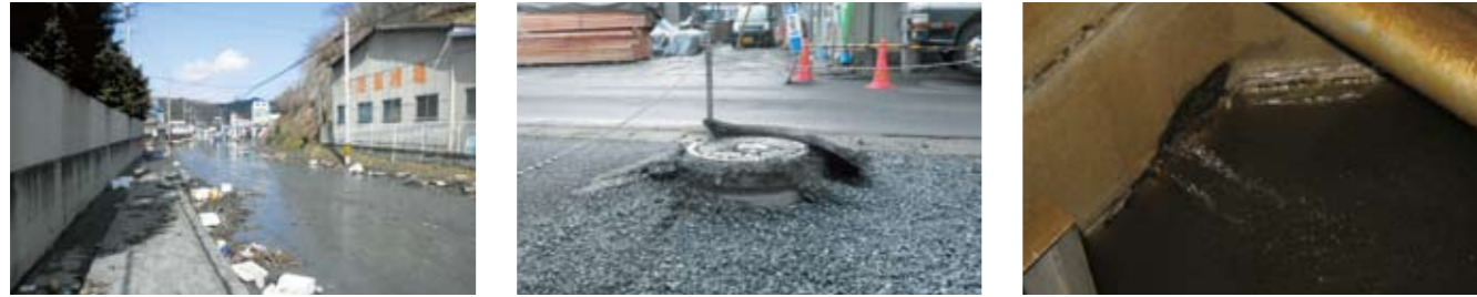
写真1. 地震被災地区 (左:路盤液状化、中央:マンホールポンプ浮上、右:マンホールからの浸入水)
